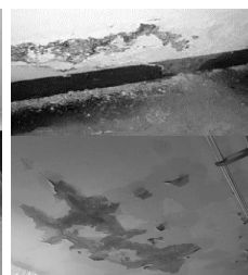
Tetti e Muri, Infiltrazioni d'Acqua nel Terreno
