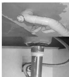
Perdite di Tubazioni dell'Acqua / Perdite di Tubazioni Idriche
