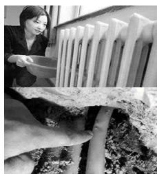
Perdite di Tubazioni di Riscaldamento / Perdite di Tubazioni di Riscaldamento a Pavimento
