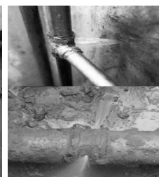
Sistema di Irrigazione Antincendio
