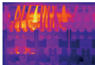
Sottoporre gli impianti a manutenzione: individuare le temperature troppo elevate in interruttori e componenti elettrici prima che possano verificarsi delle rotture.
