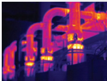
Messa a fuoco manuale—solo la tubazione anteriore è a fuoco
