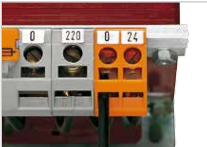
Großer Anschlussraum und gute Sicht auf die Anschlussstelle
